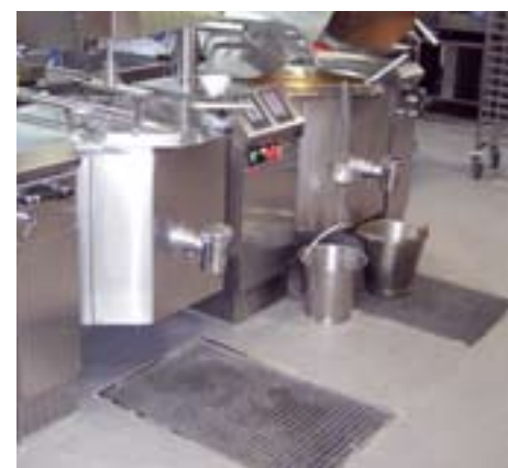
► Keukenkanalen onder de toestellen in de grootkeuken
