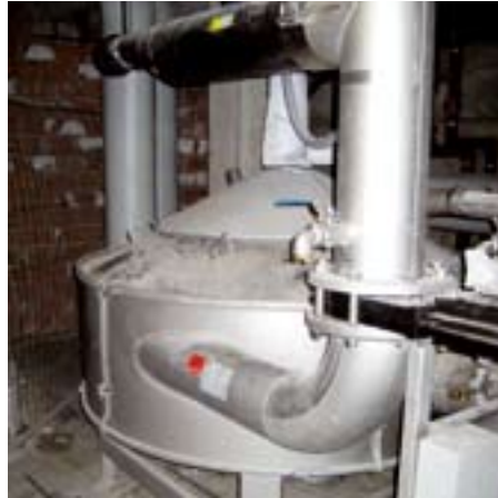
► Le séparateur de graisses Lipator au niveau -1.
