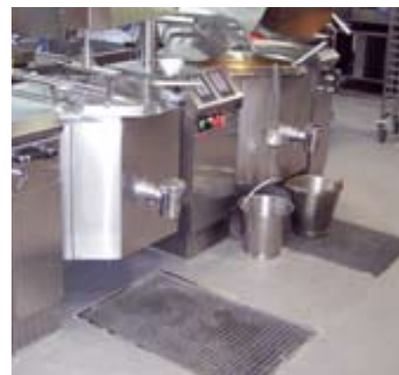
► Caniveaux de cuisine sous les appareils de la cuisine industrielle
