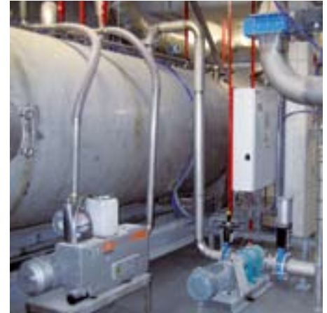
► Réservoir de stockage et broyeur
